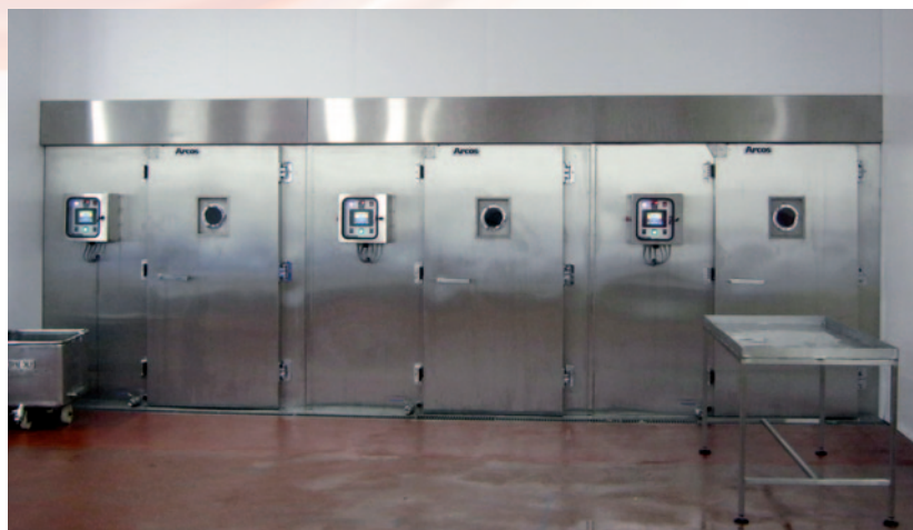
Façade de 3 tunnels de séchage
